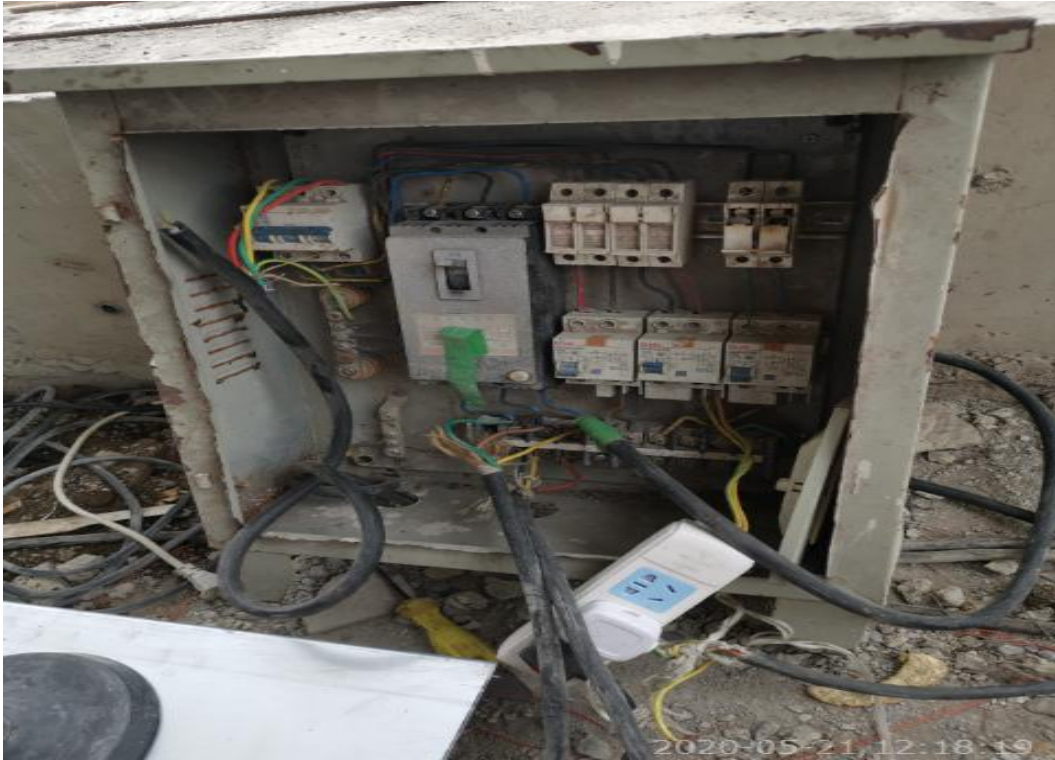
现场未按三级配电要求设置。
