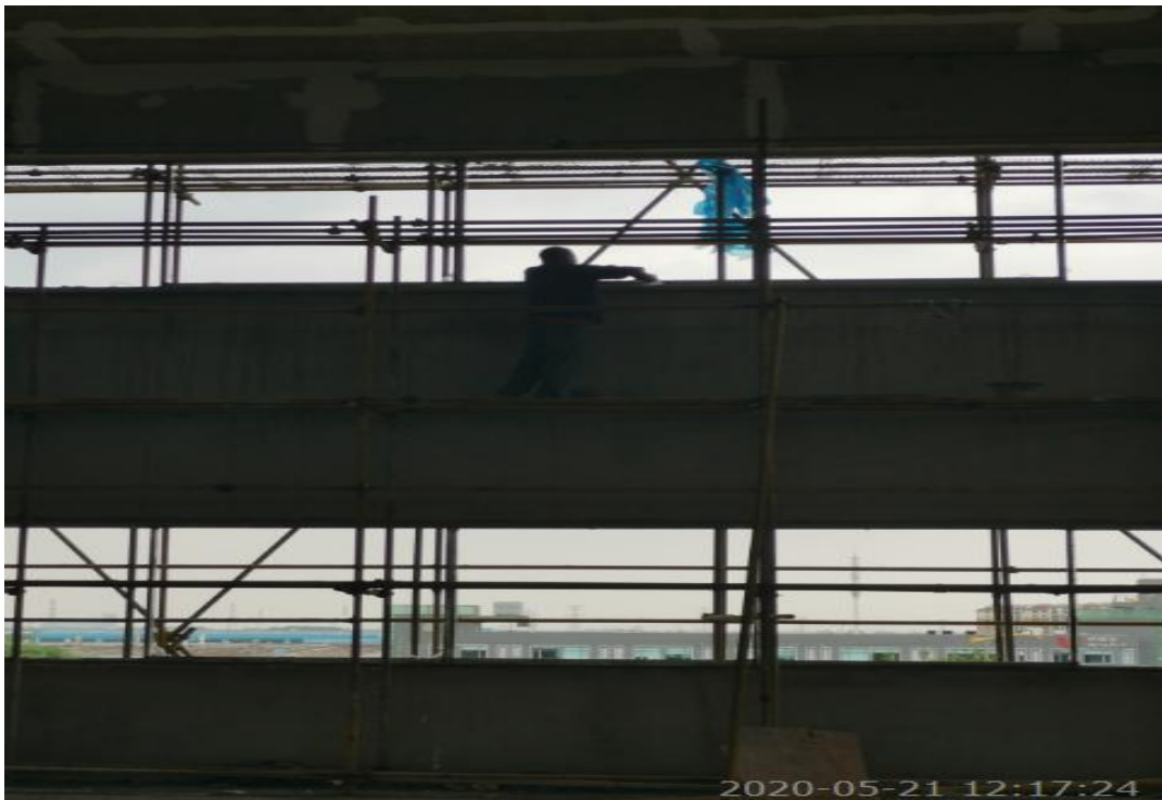
进入施工现场的人员未佩戴安全帽。
